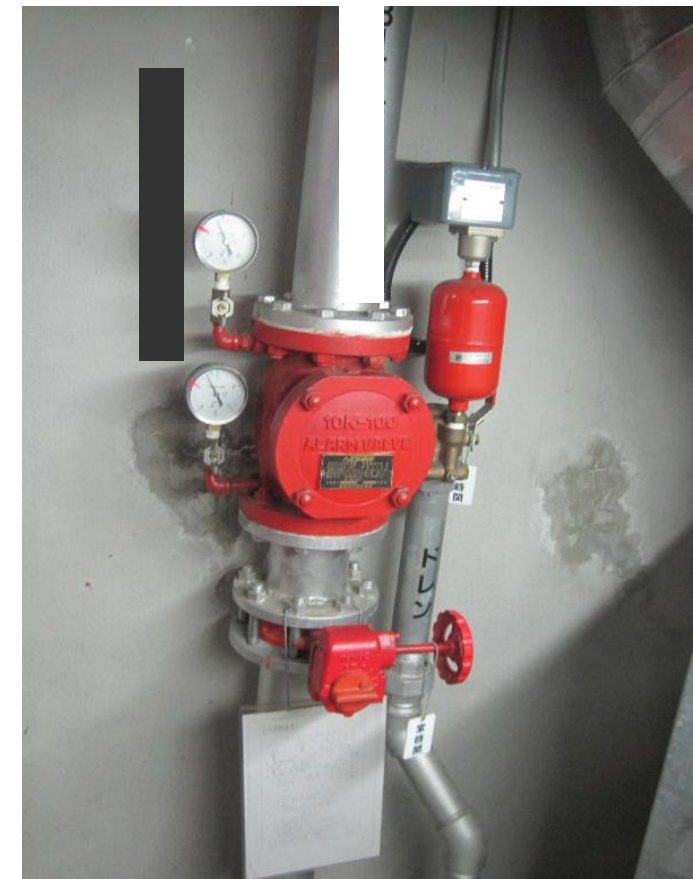
〈泡消火設備自動警報弁〉
