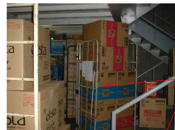
避難階段室内不適切状態
