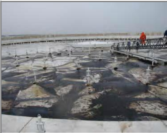
スロッシングにより 原油が溢流した浮き屋根上部の状況 (出典：消防研究センター)
