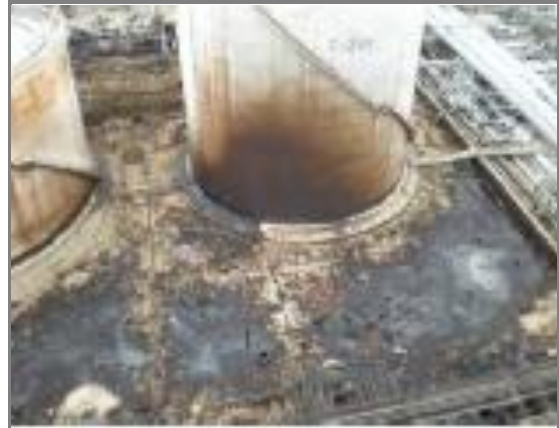
配管の破損により 重油が流出したタンク (出典：仙台市消防局)
