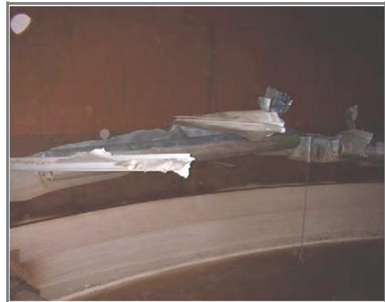
スロッシングにより破損したタンク 側板付近の浮き蓋の損傷状況 (出典：消防研究センター)
