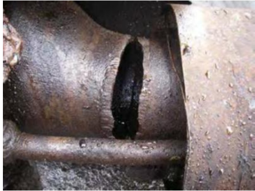
配管の破断部拡大 (出典：消防研究センター)
