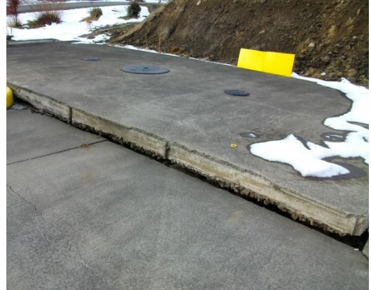
液状化による上部スラブの浮き上がり (出典:全国危険物安全協会)
