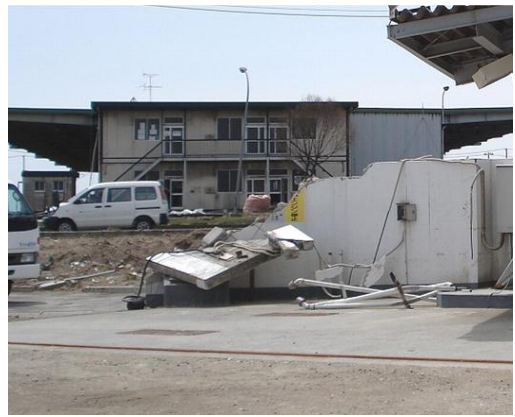
津波により破損した防火塀 (出典:全国危険物安全協会)
