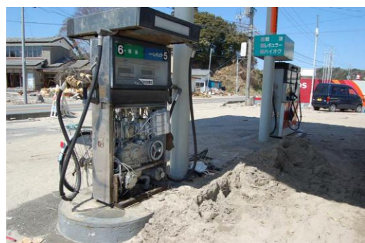
いわき市内の被害SS (出典:全国石油商業組合連合会)
