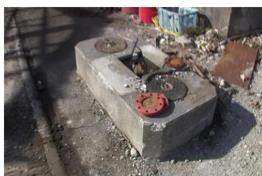
固定給油設備が欠損したアイランド (出典:危険物保安技術協会)
