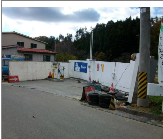
地震により傾斜した防火塀 (出典:全国危険物安全協会)
