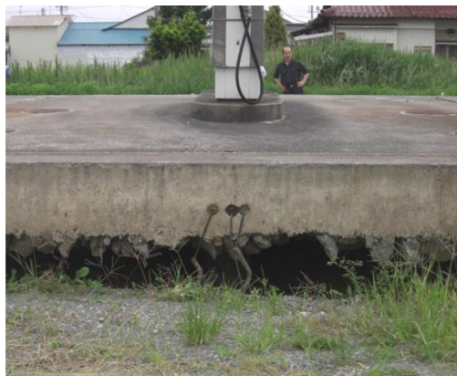
液状化による上部スラブの浮き上がり (出典:全国危険物安全協会)
