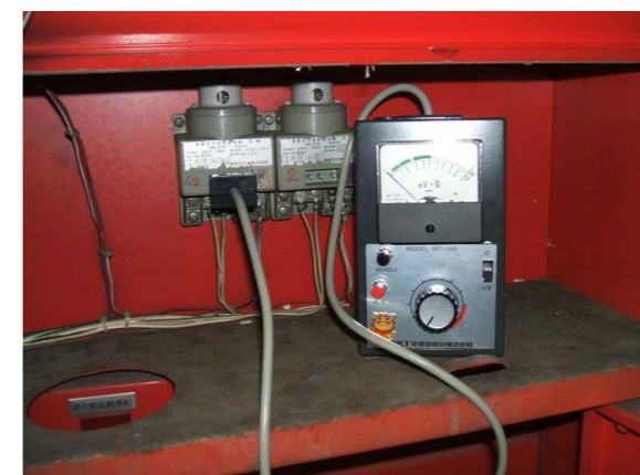
メーターリレーによる試験
