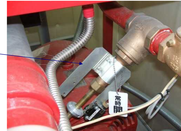
呼水槽バルブの弁監視
