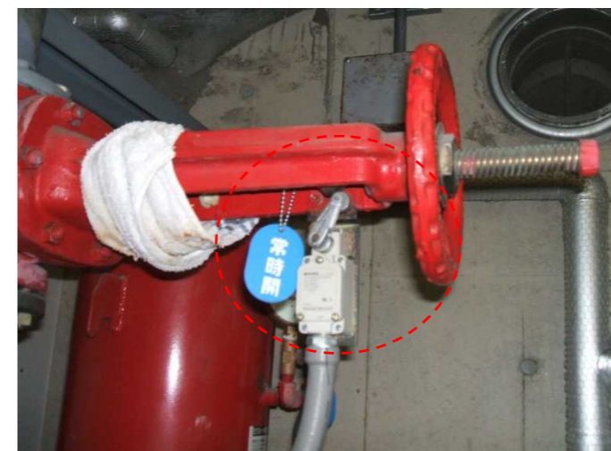
スプリンクラーポンプ仕切弁の 弁監視
