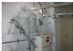
スプリンクラー配管が破損した状況
