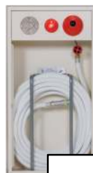
新しい屋内消火栓設備
